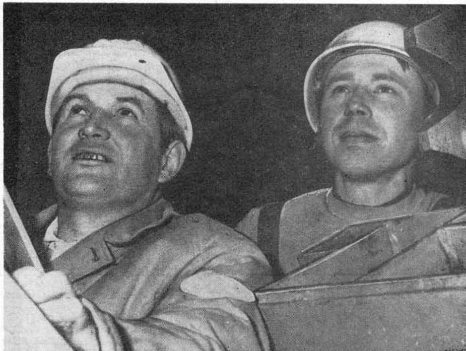
Бригадир Зденек Пейс и Юрий Семин на монтаже первого советского эскалатора на станции «Малостранская».
