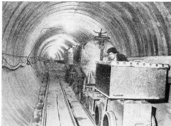
Рис. 5. Состав пневмоподатчиков в тоннеле.
